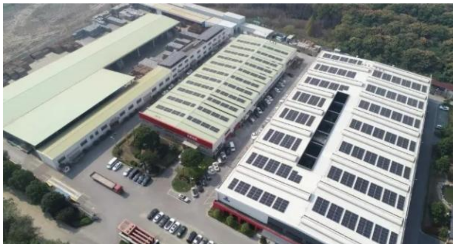
光伏发电设备
